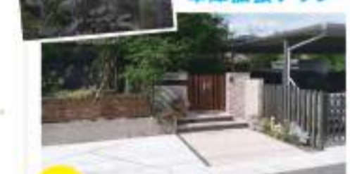
After 危険なブロック塀を撤去し機に撤去。 子供が免許を取って車庫も増設。
